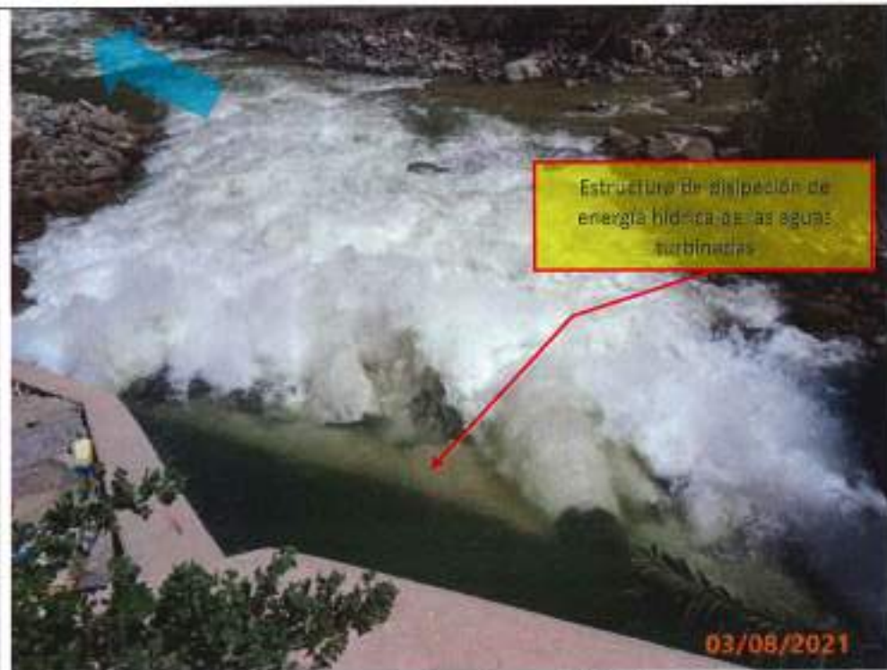
Fotografía N° 14: Descarga de aguas turbinadas al cauce del río Huaura, en este punto se evidencia la estructura disipadora de energía hídrica tipo barraje de concreto y roca.
