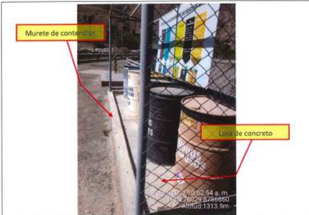
Fotografía N° 21: Contenedores de metal al interior de una poza de contención de concreto, no se observa fugas o derrames en el punto de almacenamiento inicial del reservorio Picunche.
