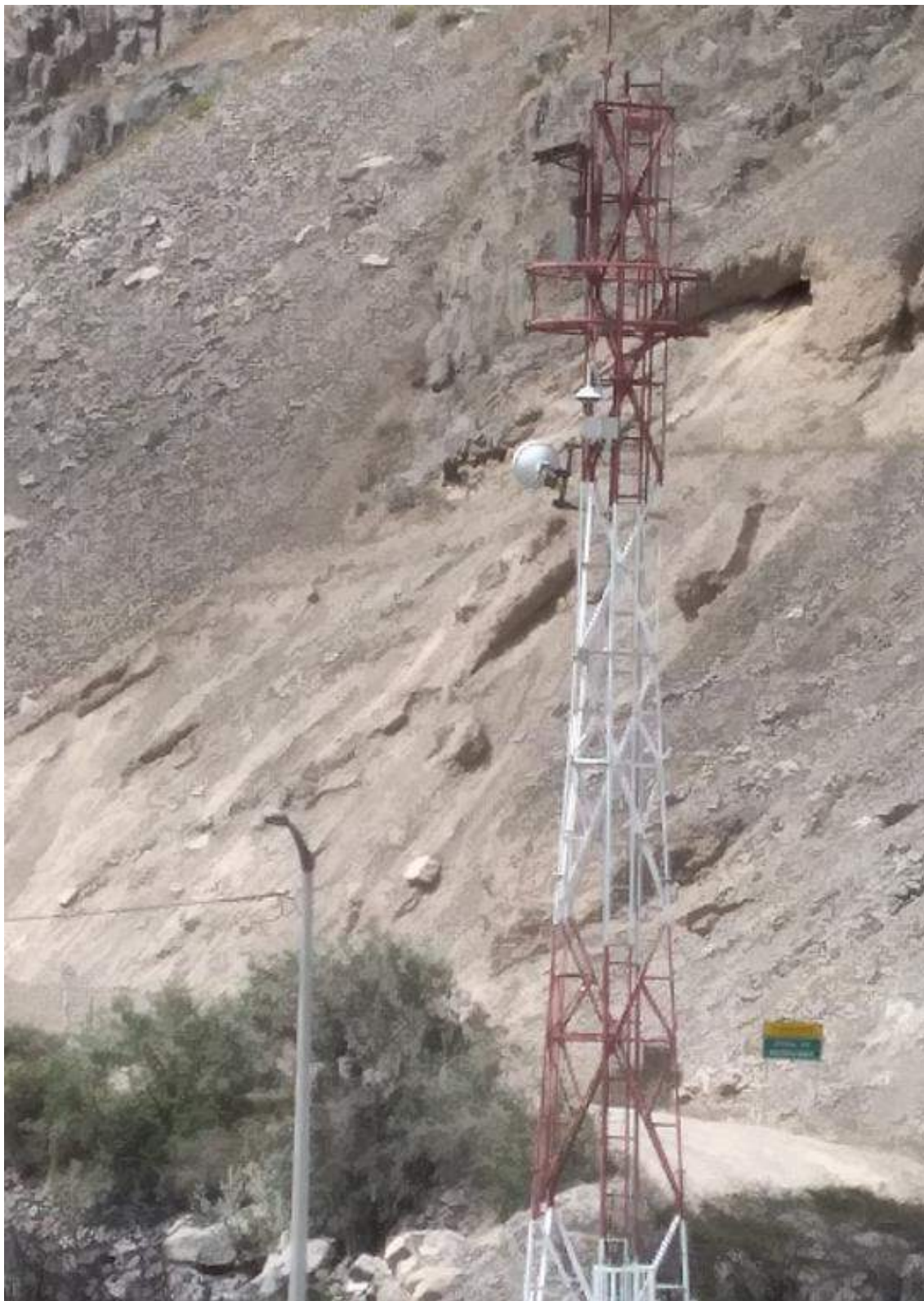
Fotografía 3-2 Vista actual de estación de telecomunicaciones
