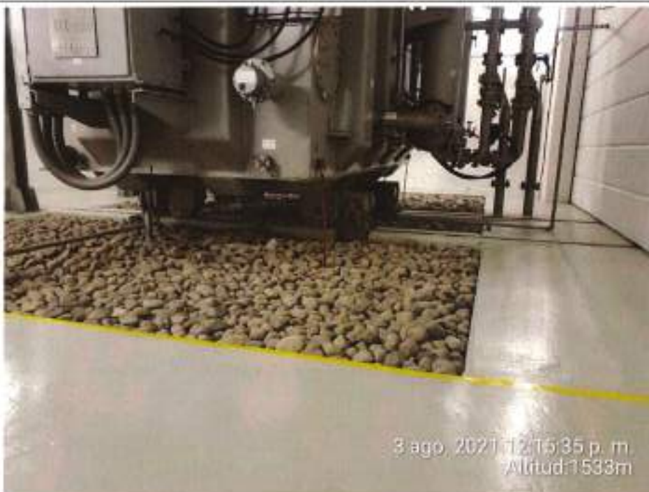
Fotografía N° 5: Transformador de potencia 2, instalado en caverna donde se aprecia el pozo de contención cubierto con piedra chancada. No se evidenciaron rastros de fugas o derrames de aceites.
