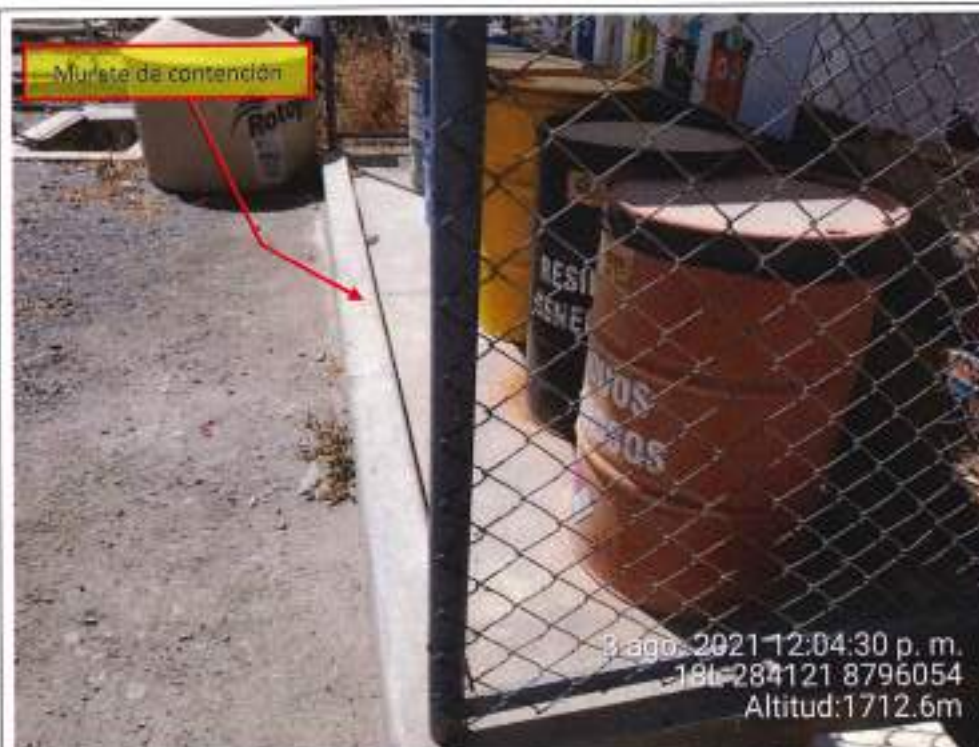
Fotografía N° 23: Contenedores de metal al interior de una poza de contención de concreto, no se observa fugas o derrames sobre la losa de concreto.
