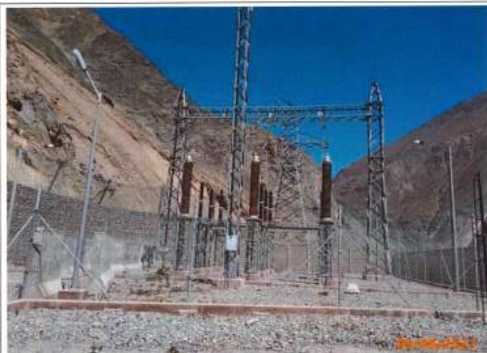
Fotografía N° 1: Vista general del Patio de llaves de la C.H. Cheves, cubierto con piedra chancada. No se evidenciaron rastros de fugas o derrames de aceites.
