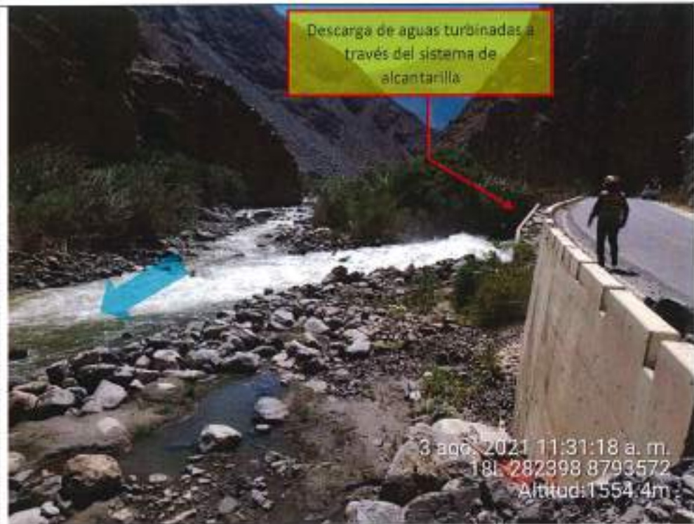
Fotografía N° 13: Descarga de aguas turbinadas al cauce del río Huaura, no se observa erosión en ambas márgenes del río.
