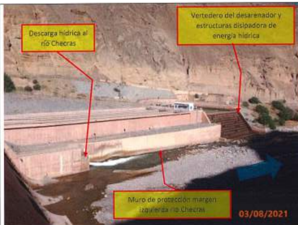
Fotografía N° 8: Descarga hídrica desde la presa Checras al cauce del río Checras y rebose de agua desde el vertedero de los desarenadores, hacia el cauce del río Checras.
