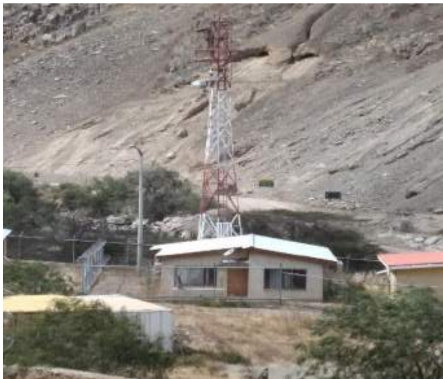
Fotografía 6.2-3 Estaciones de telecomunicación (PAD-CHE-02)
